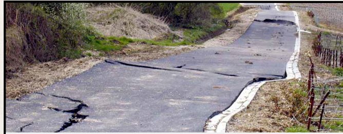
Glissement de terrain à Boursault en novembre 2000
